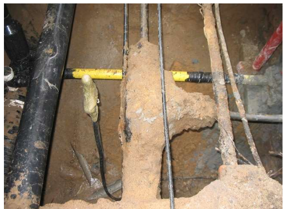
Bild 5: Metallene Installationen im Erdreich
